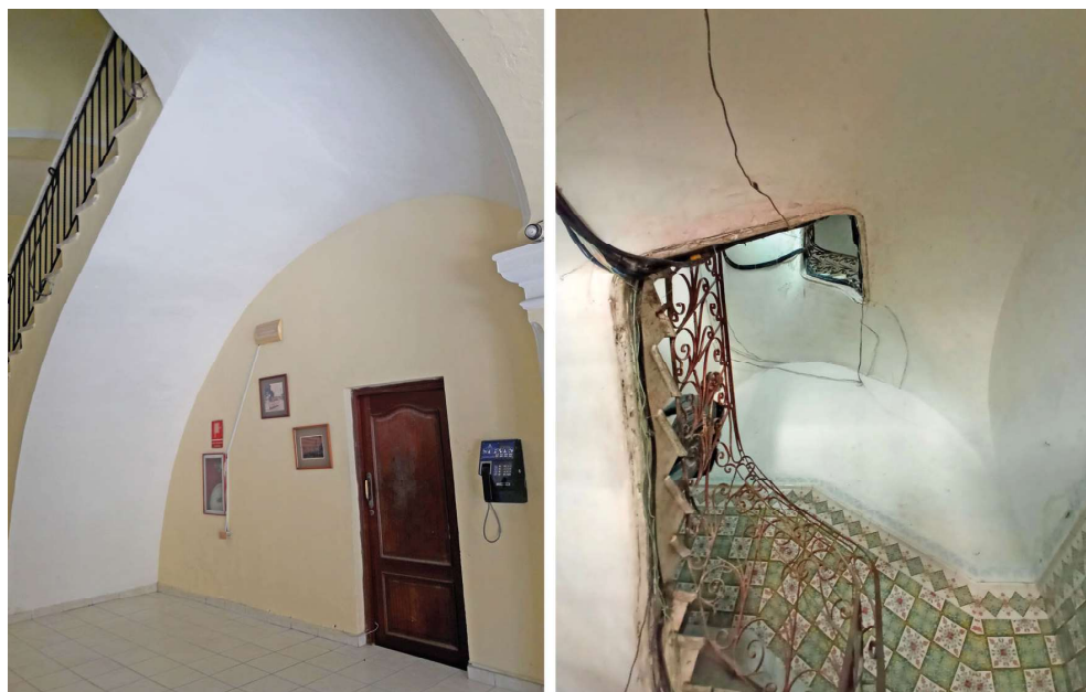
Figura 5. a) Hotel Tejadillo, La Habana; b) C/ Villegas 216, La Habana. Imagen propia del autor
